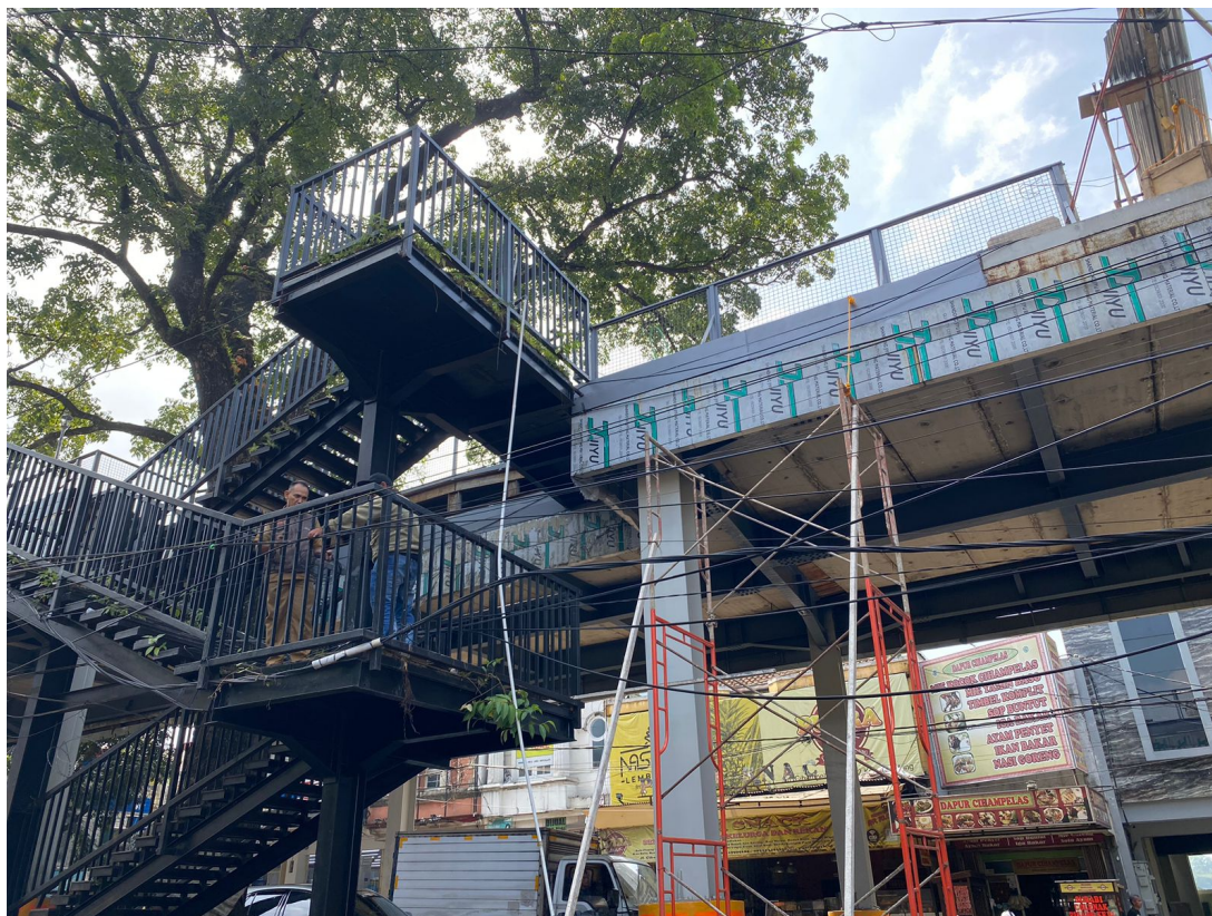
Kabel semrawut di kawasan Skywalk Cihampelas.
